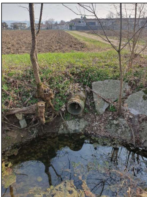
Figura 19: dettaglio dello scarico sul Rio La Roggia
