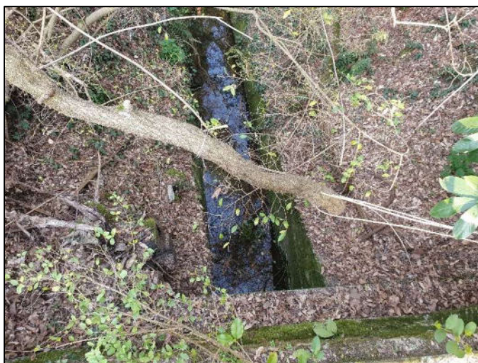
Figura 23: vista dall'alto dello scarico della fognatura verso il torrente Raboso
