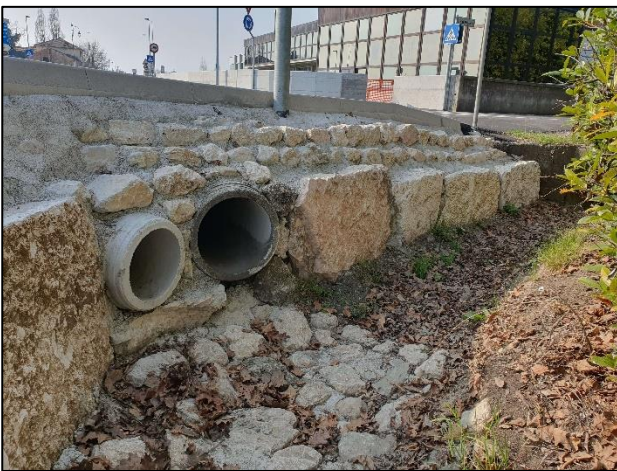
Figura 15: dettaglio dello scarico della fognatura sul Rio la Rosta
